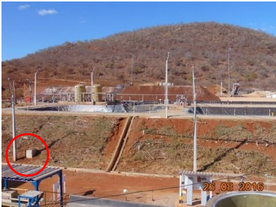
Exemplo de Piscinas de solução ácida da Planta de Testes, impermeabilizadas com lonas e providas de caixa de inspeção (destacada) para diagnóstico imediato de eventuais vazamentos.
