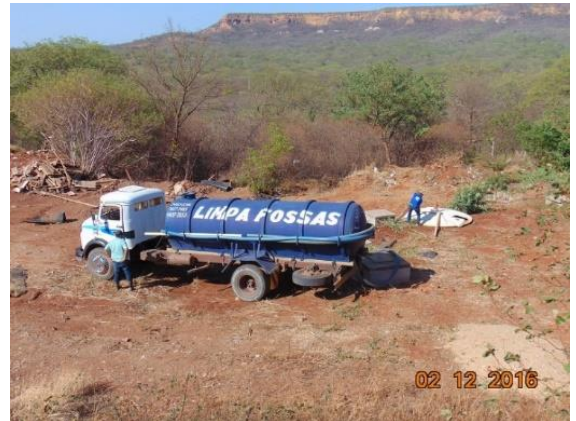
Exemplo de limpeza de fossa séptica instalada na Planta de Testes para destinação adequada de lodo sanitário.
