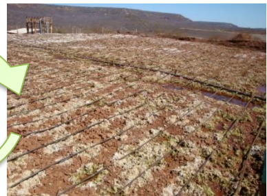
Rede de tubulação plástica montada em cima das Pilhas para gotejamento lento com solução ácida diluída com água
