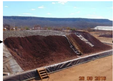
Pilhas de lixiviação com 4m de altura, montadas sobre pátio impermeabilizado com manta plástica
