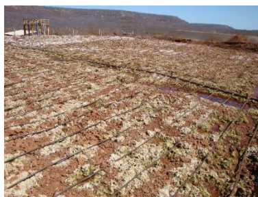
Rede de tubulação montada sobre as Pilhas para irrigação por gotejamento com solução ácida diluída
