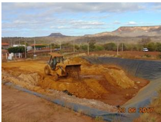
Exemplo de disposição de rejeito sólido gerado no processo da Planta de Testes em bacia de rejeito impermeabilizada com lona.
