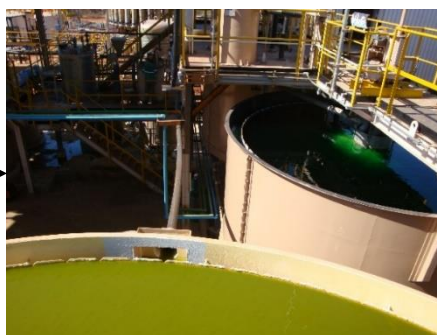
Tanques de precipitação da planta de Testes separando Níquel e Cobalto de outros minerais indesejados (ferro, alumínio, cromo), pela adição de calcário
